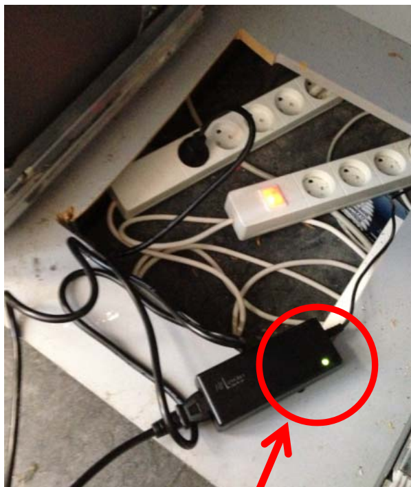
Transformeren lyser grønt
